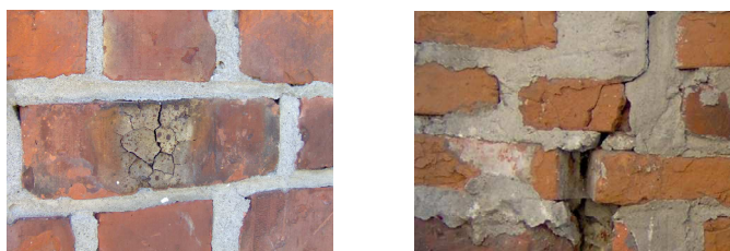
Rys. 3 Uszkodzenia cegieł Fig. 3 Damaged bricks
